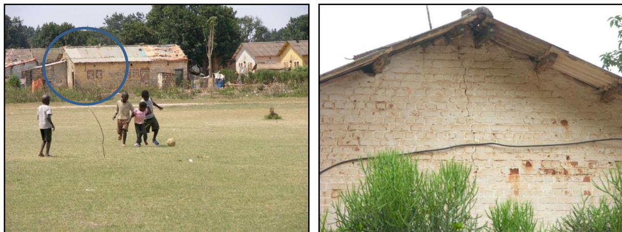
Photos 27: Terrain de foot et maisons fissurées de Musonoi (C.Peyer/PPP)
