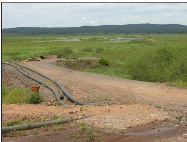
Photo 16: Station de pompage de l'eau pour les usines de MUMI au bord de la rivière Kando (C.Peyer/PPP)
